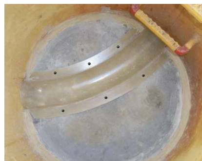
1 インバートカバーを仮置きしアンカー用下穴を開ける
