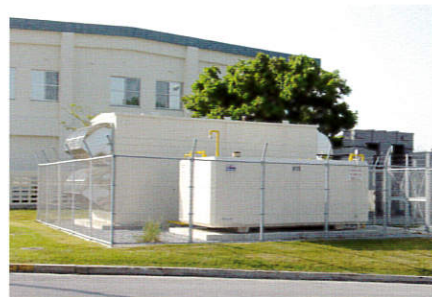
電話局発電機 (沖縄米軍基地)
