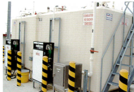
軍用車両給油取扱所 (沖縄米軍基地)
