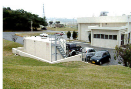
レストランのボイラー用 (沖縄米軍基地)
