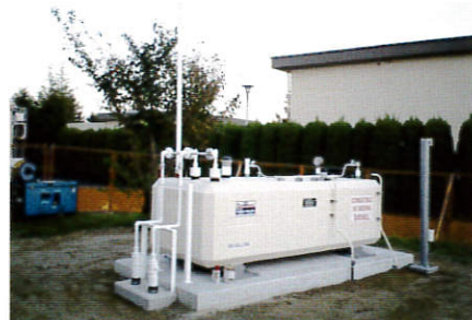
自家発電機用 (米軍岩国基地)
