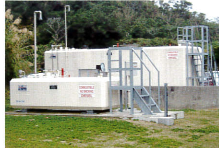
発電機用(手前)及び レストランのボイラー用 (沖縄米軍基地)
